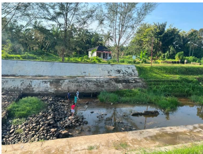
Gambar 1 Kondisi bendung dengan kekurangan debit air
