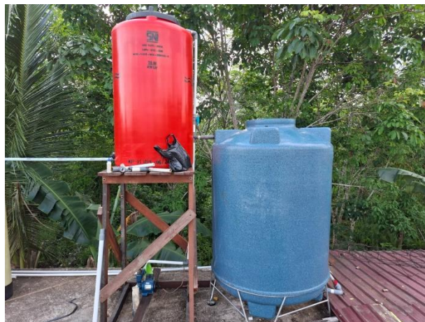
Gambar 2 Instalasi Pengolahan Air
